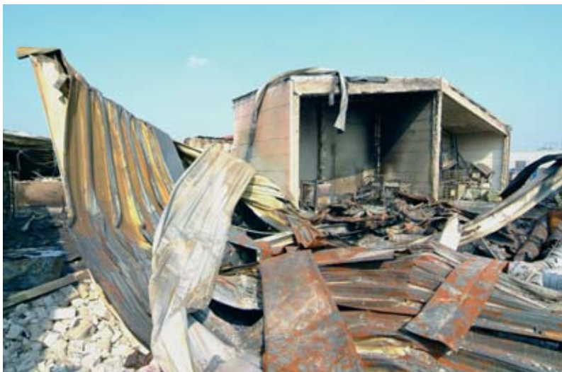
Typisches Bild: Nach einem Großbrand ragt eine Halle aus Porenbeton-Montagebauteilen nahezu unversehrt aus den Trümmern. Der gesamte Rest der Fabrik wurde von den Flammen zerstört.
